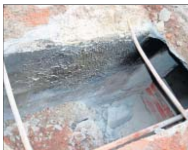
Die meterdicken Fundamente trafen vor Teeröl.
